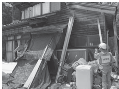
被害調査の様子
