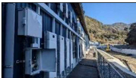
図. PCS蓄電池
