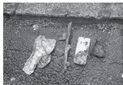
マンホールと中継ポンプに詰まっていたゴミ
