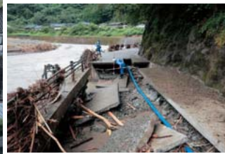
▲氾濫した万江川の流れの強さに柚木川内地区の道路もえぐり取られた。屋形から柚木川内の家屋も床上や床下浸水が相次いだ。被害を受けた家屋には、流されたものもあった
