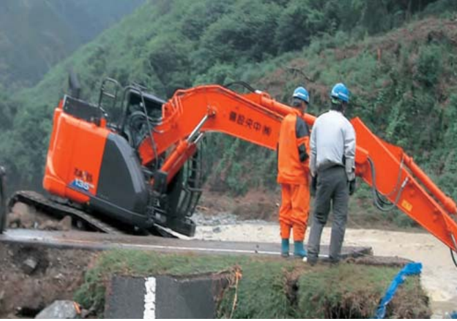
▲災害発生後、各被災箇所ですぐに開始された復旧作業(写真:県道坂本人吉線(淡島))
