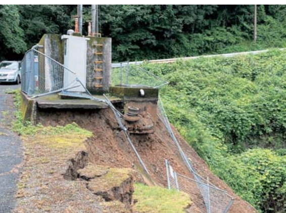
▲万江地区に生活用水を送水する第二減圧槽(笠野)の地面が崩土し、施設の異常が発生。13・14区の断水が起こった
