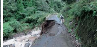
▲村内の至るところで道路の陥没や山からの崩土により道路が通行止めとなった。道路寸断により山間の地域では一時孤立状態となった
