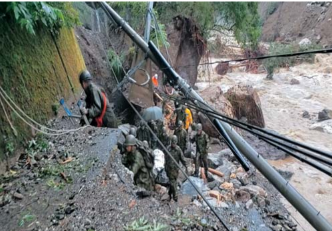
▲7月7日孤立していた大川内地区住民の救助活動 天候不良により空路から陸路に変更し救助活動を遂行
