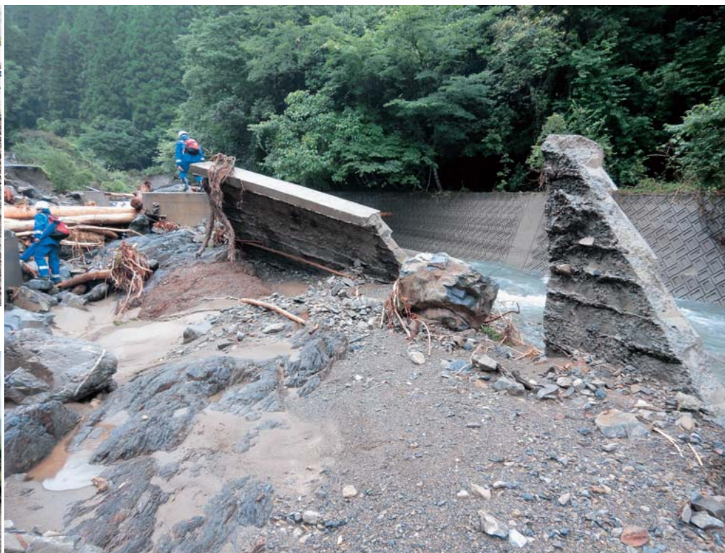
▲水が引いた後の宇那川 護岸が破壊され、道路が滅失した多くの流木も堆積している
