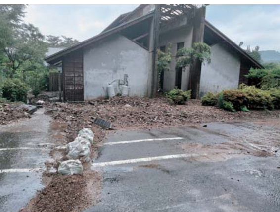
▲村内の憩いの場所である温泉ほたるでは、裏山から流出した土砂が宿泊棟「ほたる亭」を覆い、床上浸水となった
