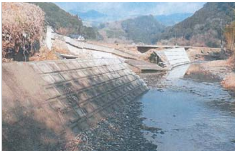
場所:下払川(山田地区)護岸崩壊
