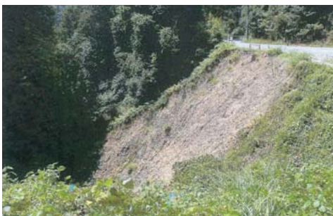
場所:村道涼松笠野線(万江地区)法面崩壊
