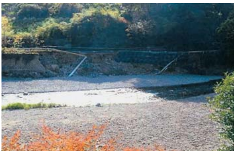
場所:村道荒神光永恵線(万江地区)道路崩壊
