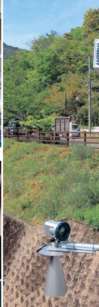
水位計・監視
