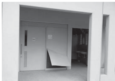
丸岡公園トイレの壁が剥がれる
