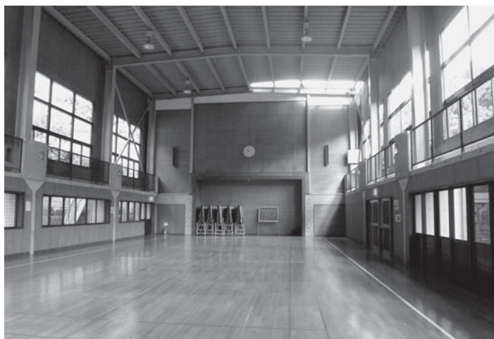
屋形多目的集会施設の屋根が剥がれる
