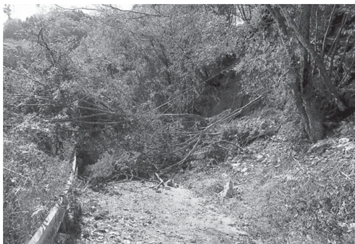
林道屋形線 倒木と崩土で通行止めとなった
