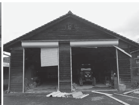
農機具倉庫のシャッターが破壊
