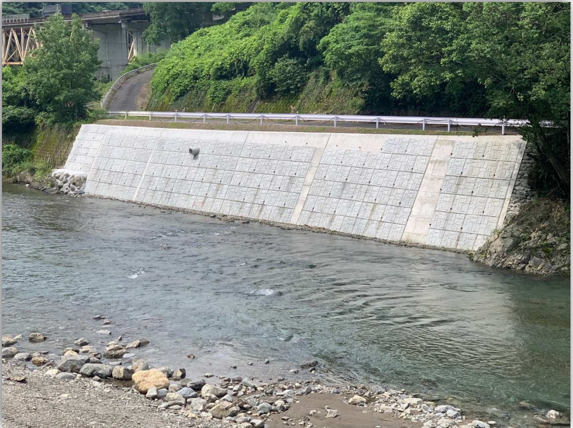
【公共土木施設災害復旧事業:村道荒神光永恵線】
