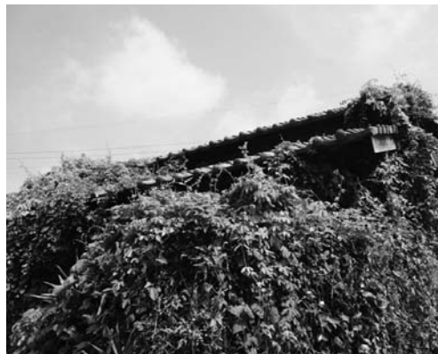
通学路に面した老朽化した民家
