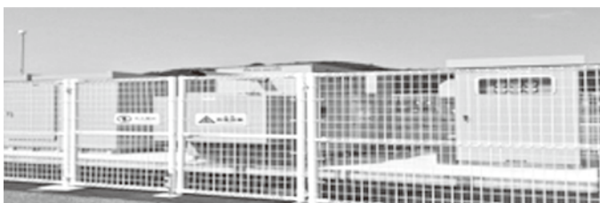
竣工した役場庁舎の非常用自家発電設備
