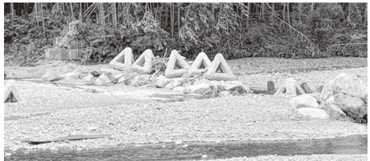
被災した下の段取水堰
