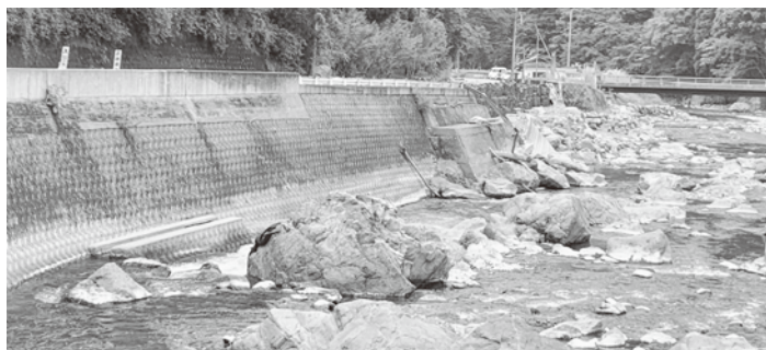
被災した濁毛取水口
