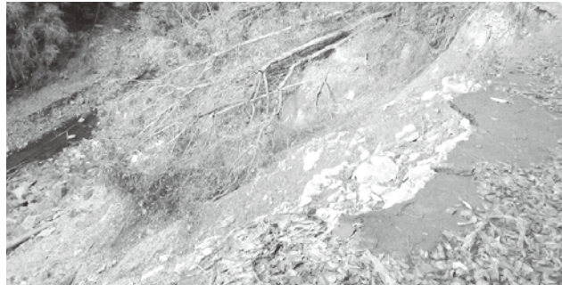
基礎路盤ごと滑落した村道(村道・岩ヶ野下払線)
