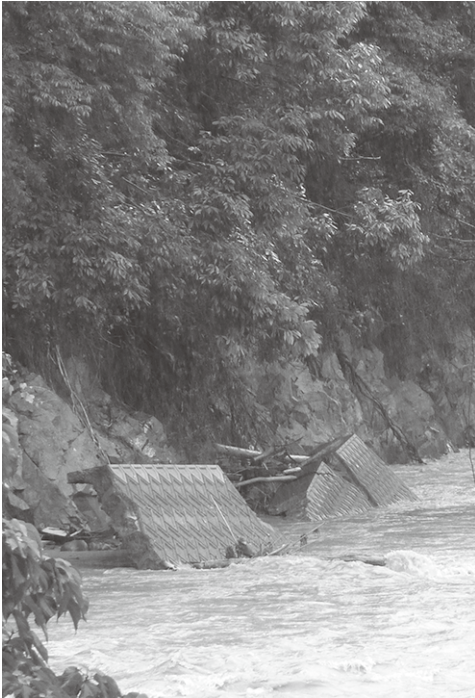
流失した万江川護岸の水田用水路
