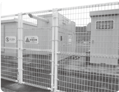
役場前非常用発電機
