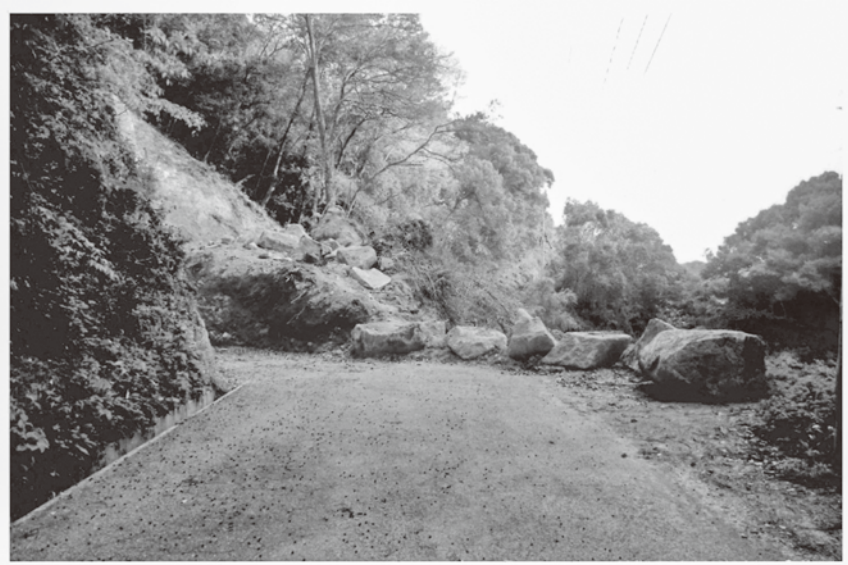
村道岩ヶ野下払線災害現場
