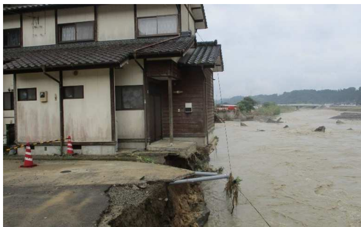
【公営住宅】建物基礎流失（城内団地）
