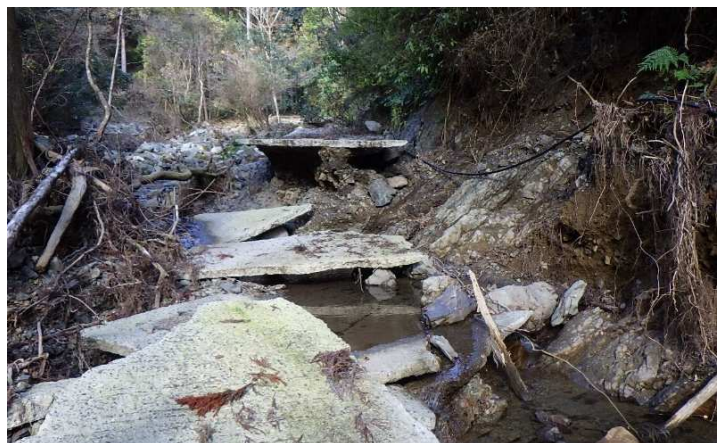
【道路決壊】柚木川内作業道
