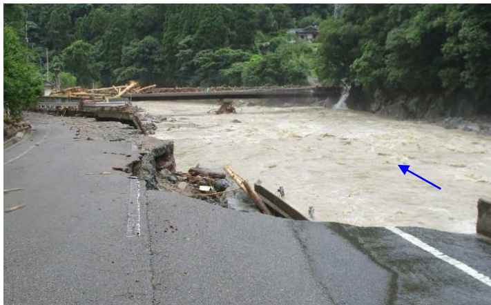
【護岸兼道路決壊】淡島地区
