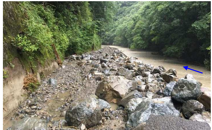
【護岸兼道路決壊】尾崎崎地区
