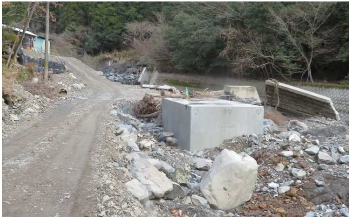
【防火水槽】土砂流入（尾寄崎）
