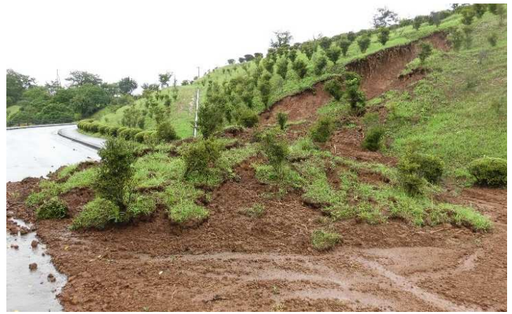
【丸岡公園】法面崩土
