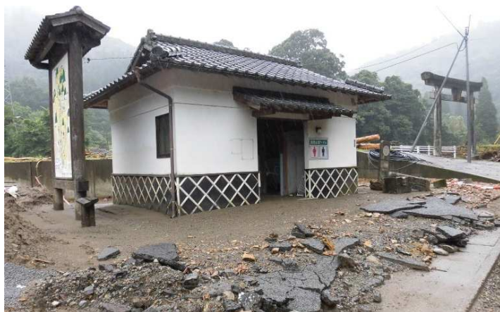
【公衆トイレ】土砂流入（淡島）
