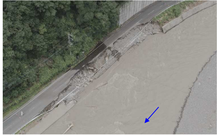
【護岸兼道路決壊】柳野地区
