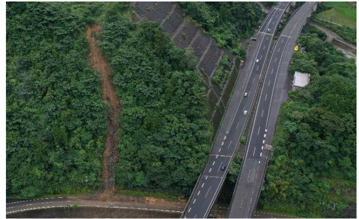
【山腹崩壊】小鶴地区
