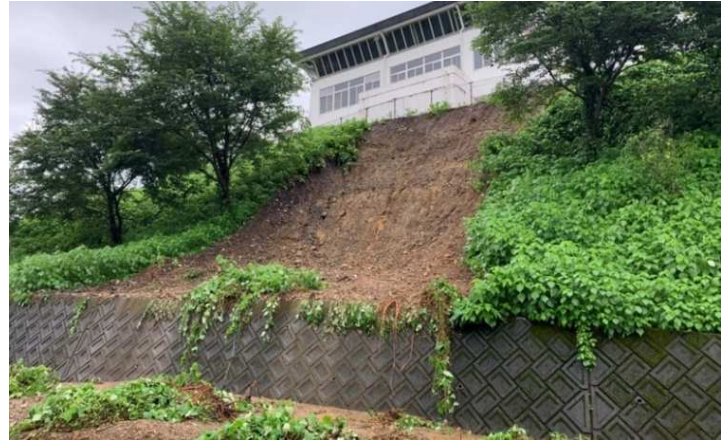
【山江中学校】法面崩土
