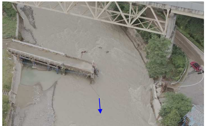
【橋梁決壊】足算瀬地区
