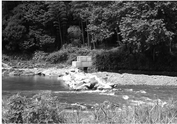
豪雨で崩れた下の段井堰
