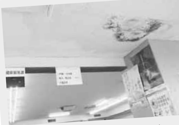
役場庁舎ロビー天井の雨漏り跡
