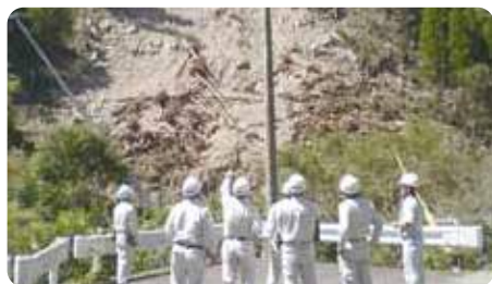
白岳地区の土砂崩れ現場
