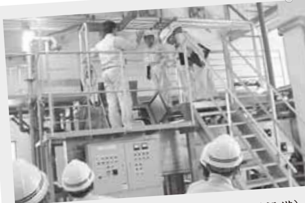
山江東部クリーンセンター(汚泥乾燥設備)
