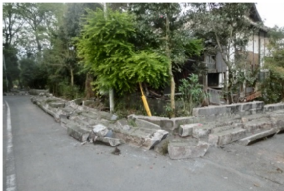
写真 3-3 組積造の塀の被害
