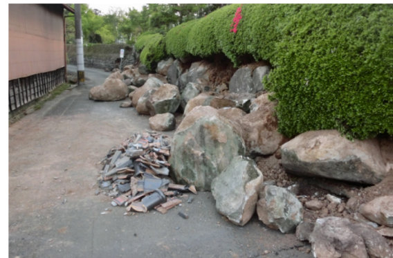
写真 3-4 石積み擁壁の被害
