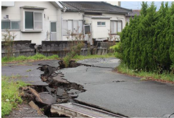
写真 3-1 地盤亀裂の被害
