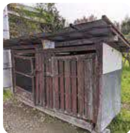
老朽化が目立つゴミステーション
